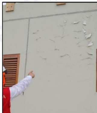
Imagen N° 103: Desprendimiento de pintura en parte exterior de muro
