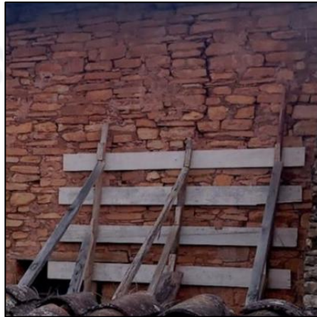
Imagen N° 45: Sector de la parte externa de la nave principal, con grietas y fisuras, con apuntalamiento por riesgo a caída de la estructura
