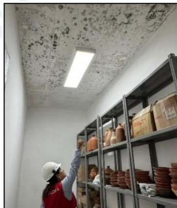
Imagen N° 96: Humedad en el cielorraso del cuarto de mantenimiento
