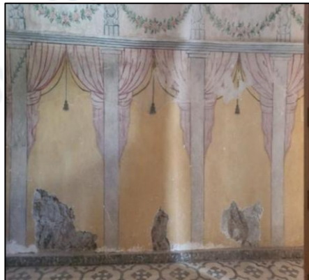
Imagen N° 74: Muros con presencia de humedad y pérdida de capa pictórica por abrasión antrópica
