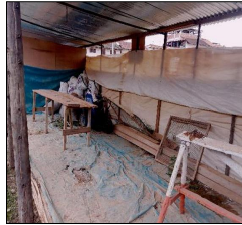
Imagen N° 46: Parte interna del campamento de la obra, en estado de abandono
