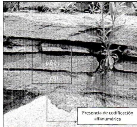
Imagen N° 94: Vista de codificado alfanumérico presente en algunos tramos de los parámetros de los andenes
