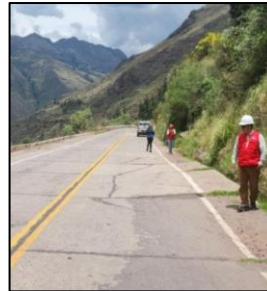
Imagen N° 131: Pavimento rígido con diferencia de nivel entre paños
