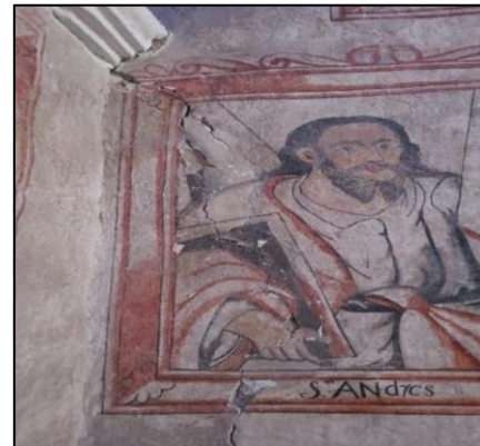
Imagen N° 75: Fisuras en el mural y en las zonas internas del templo
