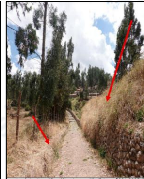
Imagen N° 88: Segmento 3 Cabeceras de muros y calzada del camino cubiertas de maleza y otras plantas
