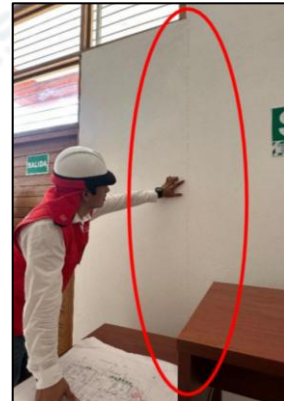
Imagen N° 101: Fisura en la pared interior
