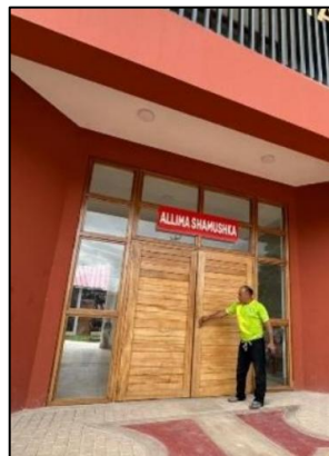
Imagen N° 97: Puerta principal presente dificultad para cerrar adecuadamente
