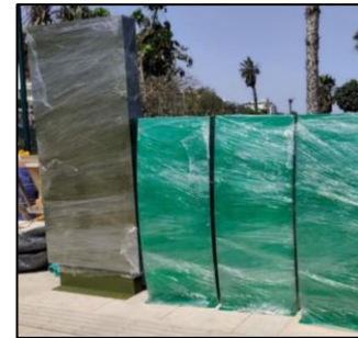
Imagen N° 118: Tótems y paneles pendientes de instalación
