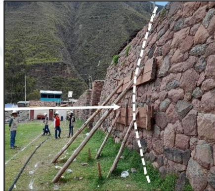
Imagen N° 89: Pandeo de muro de Anden n.º 4 Sector II recientemente intervenido
