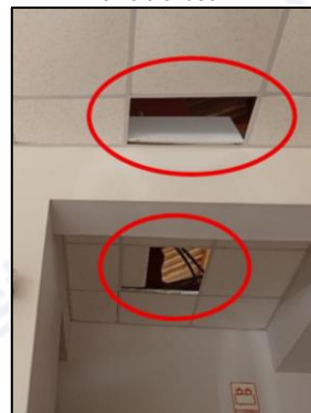
Imagen N° 105: Desprendimiento de baldosas en cielo raso
