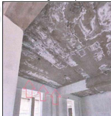
Imagen N° 128: Humedad y zonas blanquecinas en losa aligerada bloque B
