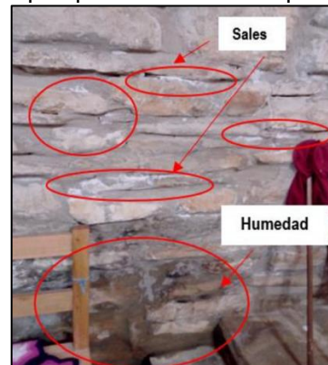
Imagen N° 44: Muros de la nave principal con signos de sales, asimismo, presenta humedad en el muro que por capilaridad asciende desde el piso
