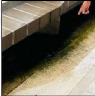
Imagen N° 113: Pendiente del piso debajo de banca, con empozamiento de aguas pluviales y moho
