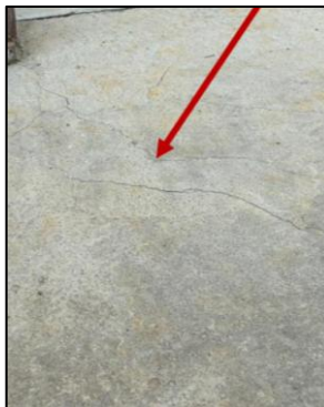
Imagen N° 111: Fisuras en la vereda de concreto
