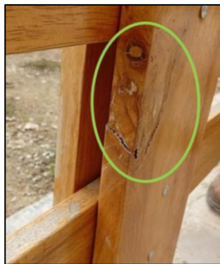
Imagen N° 104: Presencia de fisura en baranda de madera
