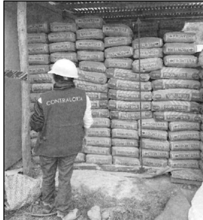
Imagen N° 82: Almacenamiento en pilas superiores a 10 bolsas de cemento
