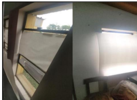
Imagen N° 63: Ventanas cubiertas con papel en el ambiente de Fondo Bibliográfico
