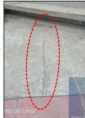
Imagen N° 121: Fisuras en la Plaza de la Integración
