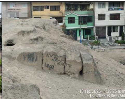
Imagen N° 17: Muro afectado por pintas con aerosol
