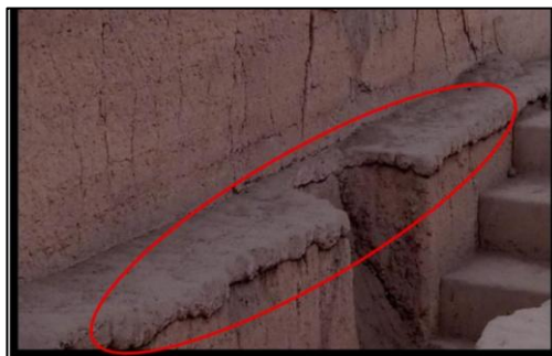
Imagen N° 28: Separación de cabeceras de muro
