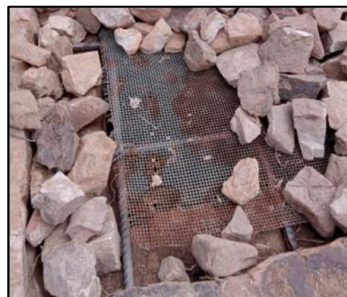
Imagen N° 39: Cajas de registro con mallas de material metálico en proceso de oxidación
