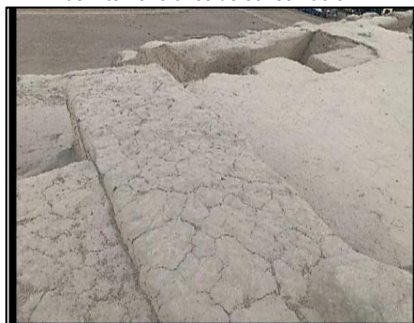
Imagen N° 27: Presencia de grietas y fisuras en las intervenciones de conservación
