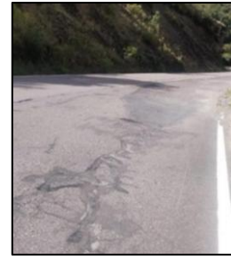
Imagen N° 132: Hundimiento en el margen izquierdo
