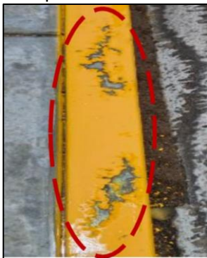
Imagen N° 110: Deficiencias de pintura en sardineles
