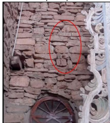
Imagen N° 43: Muros de la nave principal con fisuras en las piedras, pérdidas de mortero lo que hace que las hiladas de las piedras pierdan estabilidad
