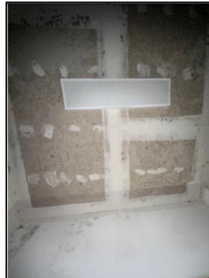
Imagen N° 100: Falta de acabado de cielorraso y presencia de humedad
