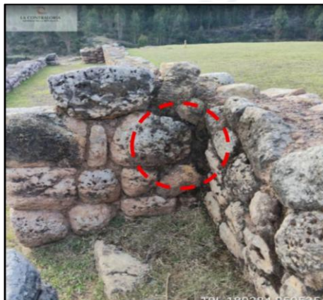
Imagen N° 68: Muros de Inkiltambo afectados por agentes naturales
