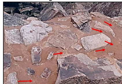
Imagen N° 40: Labores de tratamiento de cabeceras de muro presentan signos de agrietamiento
