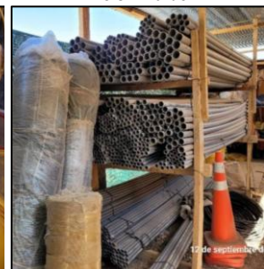
Imagen N° 124: Tuberías de PVC sin Kardex
