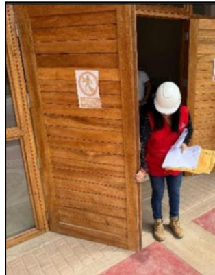
Imagen N° 99: Puerta principal choca con el piso
