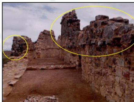
Imagen N° 37: Muro 8 con intervenciones en los morteros y cabeceras de muro, con presencia de líquenes
