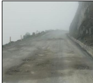
Imagen N° 130: Superficie de afirmado con presencia de baches y pérdida total de carpeta de rodadura
