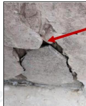
Imagen N° 112: Vacíos en los acabados del Arco de Portada
