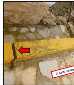
Imagen N° 109: Ausencia de relleno de la junta del sardinel
