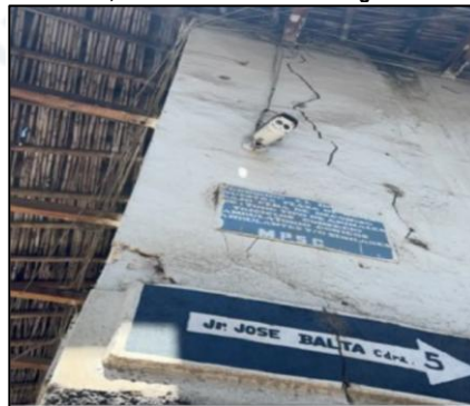
Imagen N° 47: Fisuras y grietas continuas desde el segundo hasta el primer nivel en los muros ubicados en la intersección de los jirones Sánchez Carrión y José Balta, así como filtraciones de agua de lluvia
