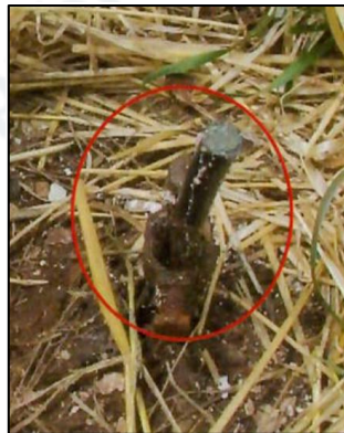
Imagen N° 91: Estado de corrosión instalados en pozos de puesta a tierra (explanada sur oeste)
