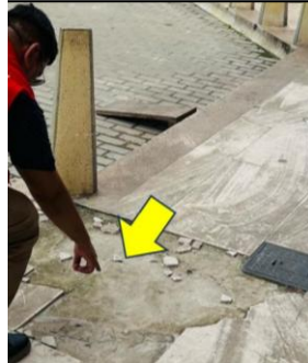
Imagen N° 114: Estado de piso de mármol
