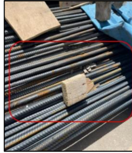
Imagen N° 126: Barras de acero almacenadas a la intemperie con presencia de óxido
