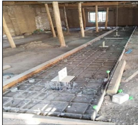
Imagen N° 78: Malla de fierro instalada preparado para vaciado, expuesto a la humedad del suelo
