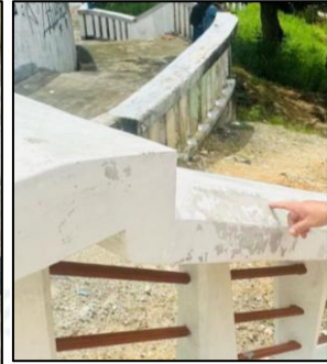
Imagen N° 115: Estado de las barandas de los miradores
