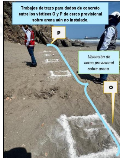
Imagen N° 84: Tramos de la obra que no cuentan con la instalación del cerco perimétrico sobre adoquín
