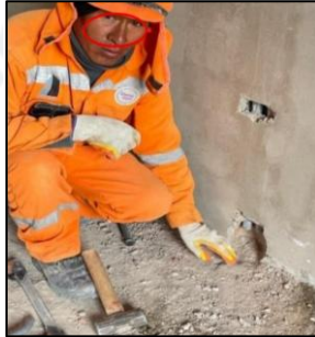
Imagen N° 125: Personal en obra picando la pared sin gafas de seguridad
