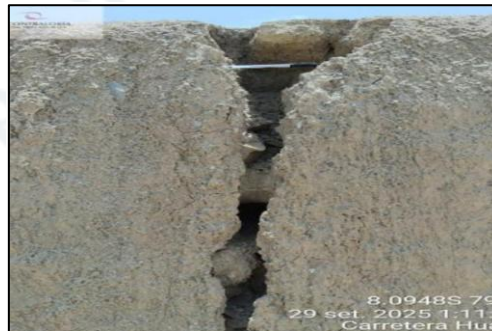
Imagen N° 20: Muro perimetral Sur con fisuras que se originan en la cabecera y alcanzan la cobertura de sacrificio
