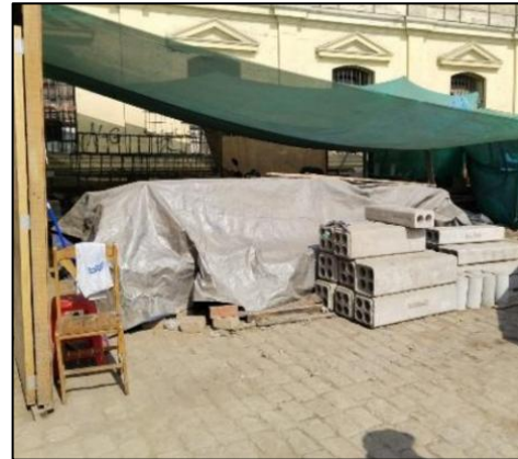
Imagen N° 79: Tuberías para instalación eléctrica y/o de comunicaciones, expuestas al ambiente y sin la protección debida
