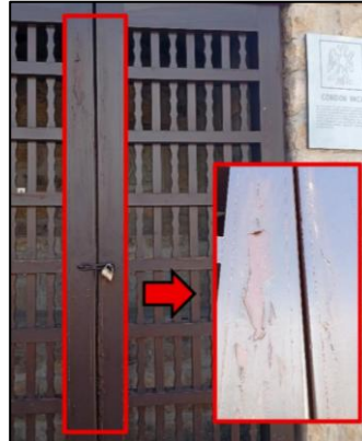
Imágenes N° 108: Deterioro de recubrimiento en puerta
