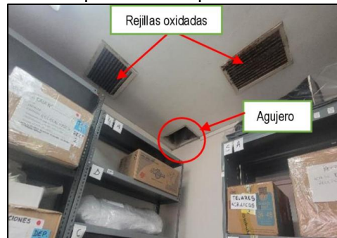
Imagen N° 64: Rejillas de sistema de ventilación oxidadas y con agujeros en el techo sin medidas de protección en el Depósito N° 3
