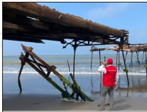
Imagen N° 76: Vista inferior de la sección colapsada del Muelle de Pisco
