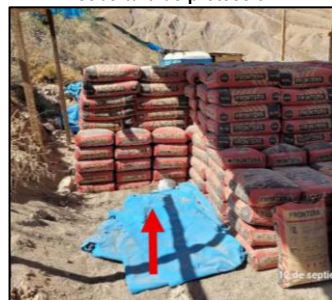
Imagen N° 122: Cemento apilado sin cobertura de protección
